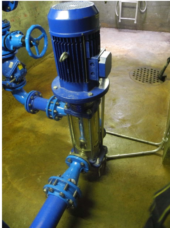
Aktuelle Notpumpe im Schacht Bachmatten
